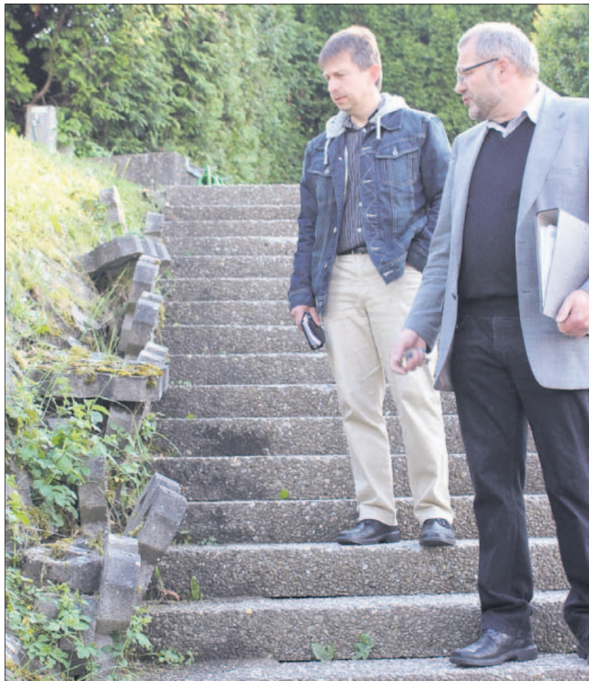
Der Berg schiebt: Unübersehbar negativ wirkt sich die Hanglage des Friedhofs aus, die Absicherung ist aus den Fugen geraten. Den Schaden betrachten Kirchenvorstandsmitglied Hartmut Assel (rechts) und Stadtrat Stefan Schuster. Foto: Christine Berger
